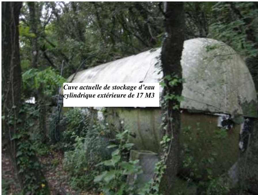
Cuve de stockage polyester calorifugée à remplacer
