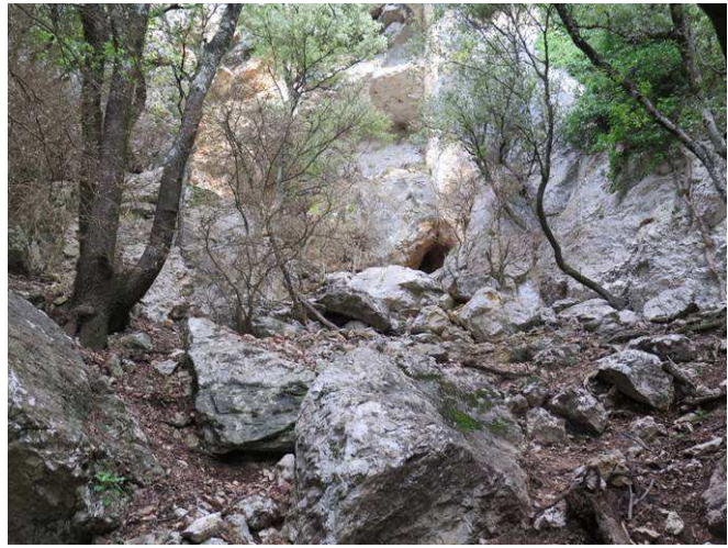
Photo 24 => embase sommitale de la combe de la fusée d'où se détachent périodiquement des blocs qui dévastent la combe (végétation, sentier...)
