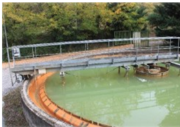
Bassin de décantation des eaux traitées à la station de la Prade
